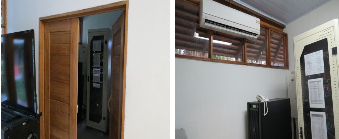
Fotos 6 y 7. Adecuación espacio de servidores en Sala de Computo. Sept de 2015
